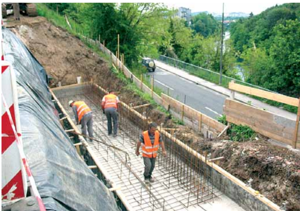
Temelj opornega zidu nad Seidlovo cesto, ki bo moral zdržati težo Koštialove ulice in prometa po njej, so mojstri temeljito utrdili. (Foto: M. Moškon)
