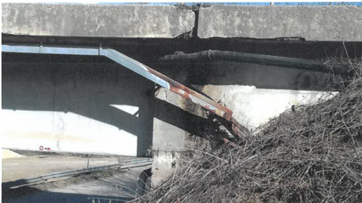
Slika 8: Poškodbe na desnem obrežnem oporniku (foto: Slobodan Novakovič).
