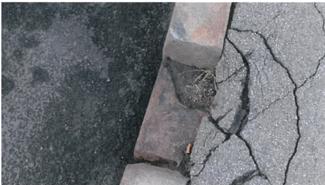
Slika 10: Poškodbe robnika in odtoka meteornih voda iz vozišča (foto: Slobodan Novakovič).
