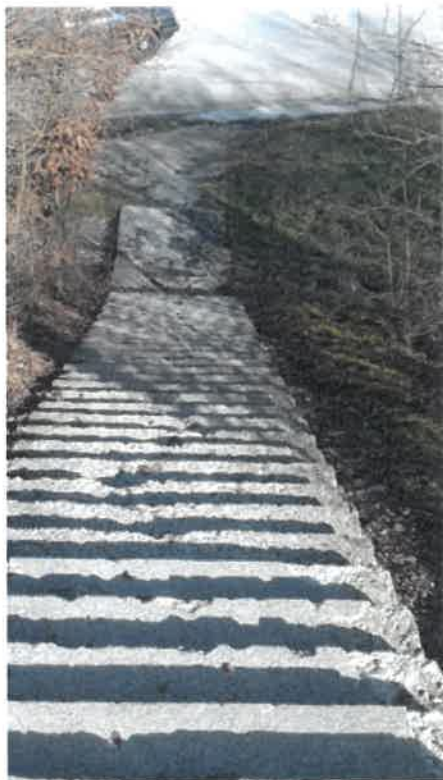
Slika 5: Povsem dotrajano in nevarno stopnišče, ki povezuje most z nižje potekajočo cesto med Ragovim in vasjo Krko, ki je brez pločnika in razsvetljave (foto: Slobodan Novakovič).
