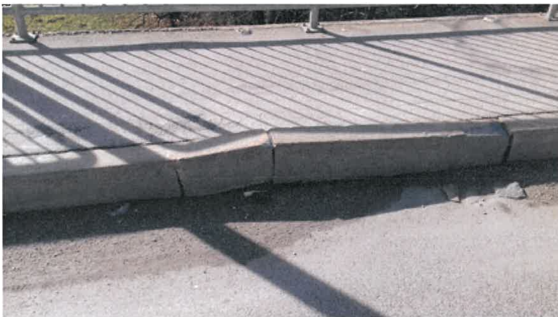
Slika 11: Deformacija cestnega robnika kot posledica dinamičnih učinkov in temperaturnih raztezkov (foto: Slobodan Novakovič).
