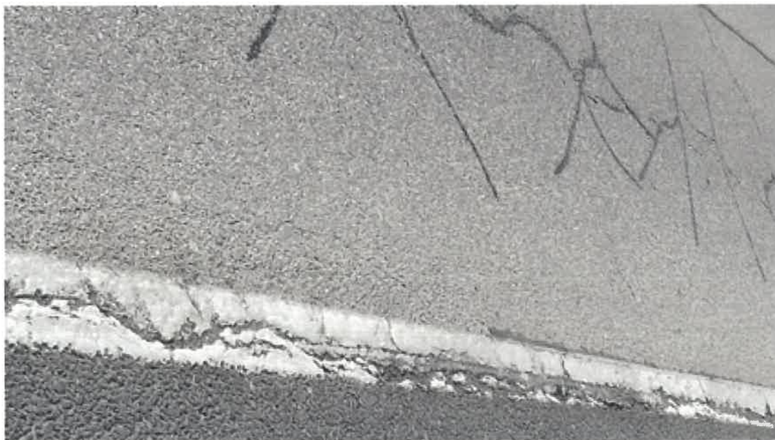
Slika 13: Vz dolžne in mrežaste razpoke vozišča (foto: Slobodan Novakovič).
