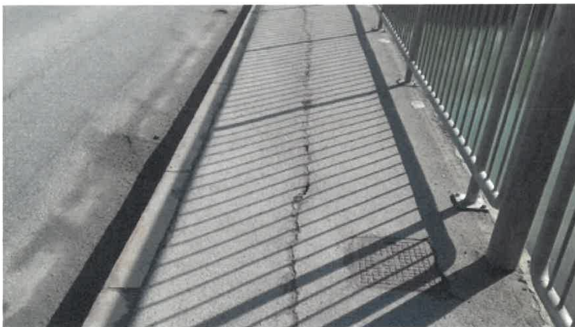
Slika 12: Vz dolžne razpoke na pločniku za pešce (foto: Slobodan Novakovič).
