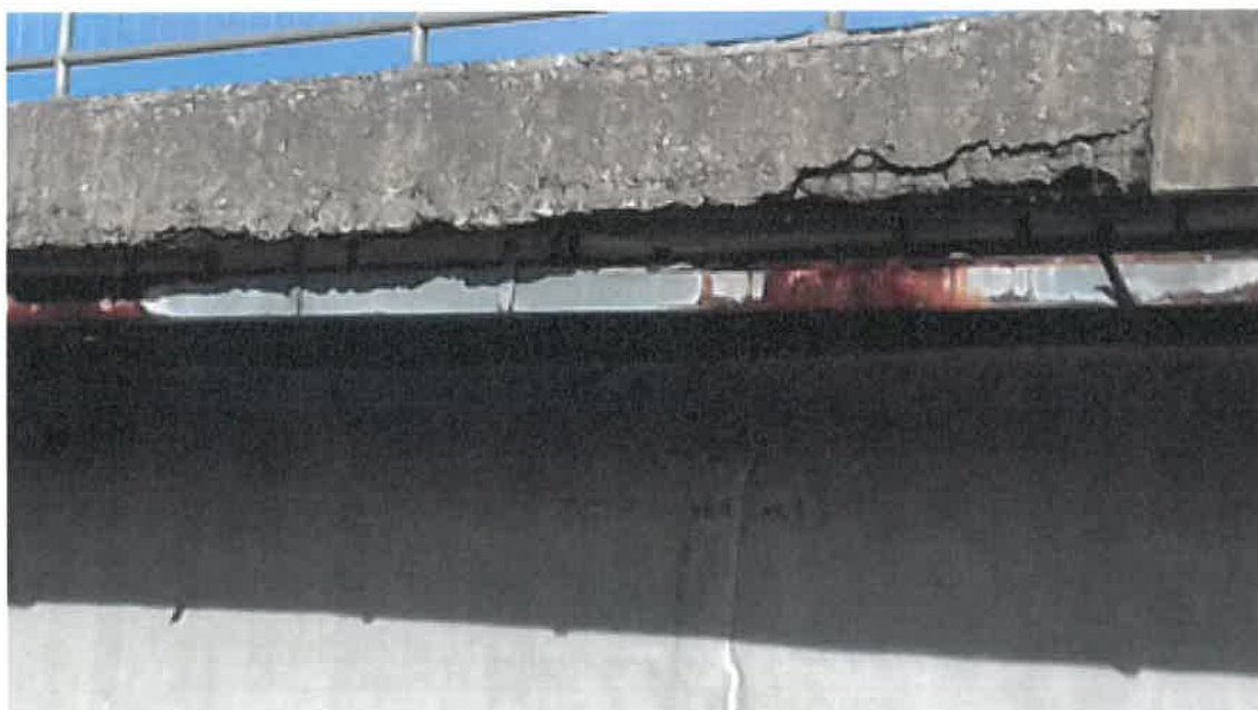
Slika 9: Poškodbe na zaključnem vencu pločnika (foto: Slobodan Novakovič).
